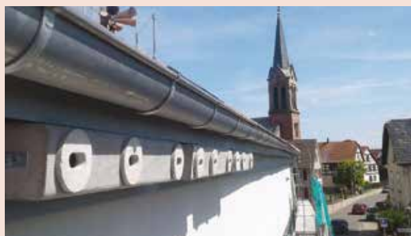
Nichoirs à martinets inclus sous la gouttière de la mairie de Muttersholtz (photo Eric Brunissen, LPO Alsace).
