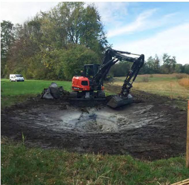
Création d'une mare sur le site CSA de l'Allmend (Osthause). Les travaux en octobre 2019. (Photos : Angéline RIEGEL et Pierre GOERTZ) / Schaffung eines Tümpels auf dem CSA-Gelände in Allmend (Osthause). Die Arbeiten im Oktober 2019. [Photo: Angéline Riegel]
